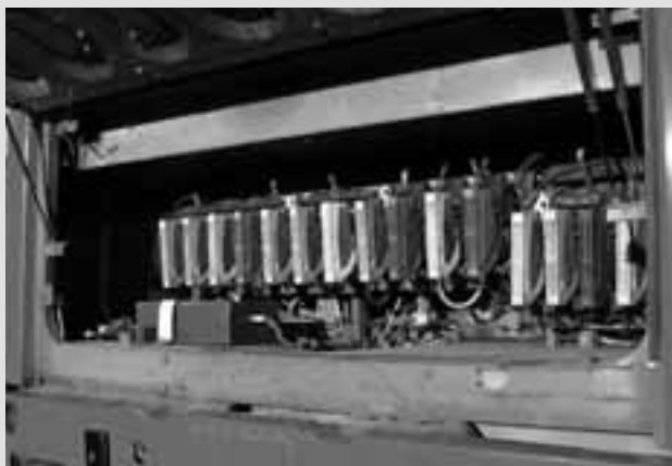
Fot. 7.14.6. Komora styczników umieszczona pod ostatnim rzędem siedzeń. Fot. Jacek Pudło, 2011
