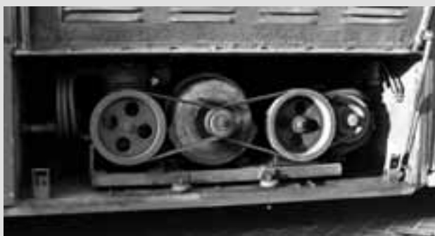
Fot. 7.14.7. Silnik pomocniczy napędzający alternator i sprężarkę. Fot. Jacek Pudło, 2011
